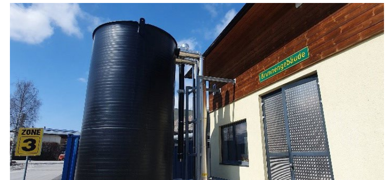
Abb. 21: Druckfilteranlage zur Enteisung und Entmanganung
